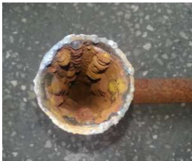
Рис.16 – Микробиологическая коррозия внутренних стенок трубы
