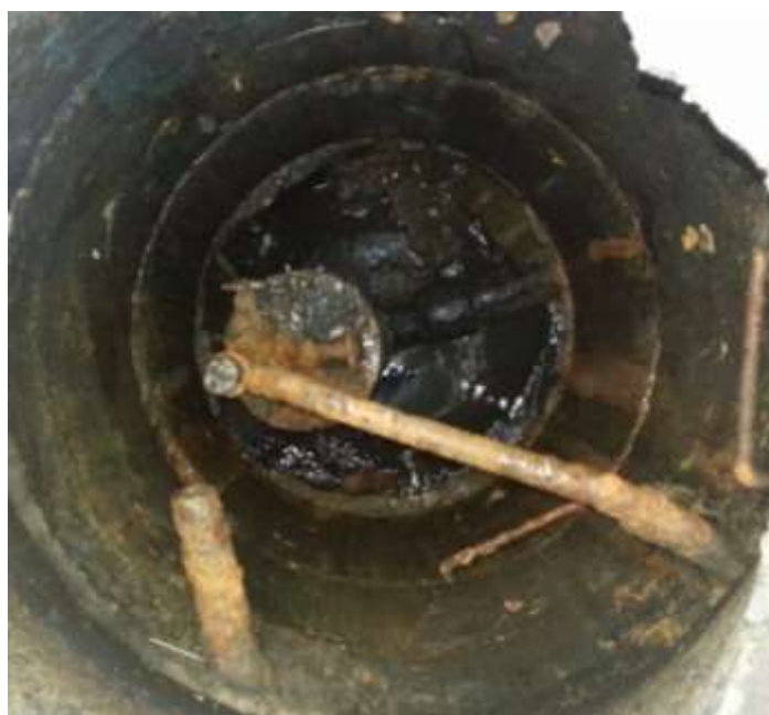
Рис.17 – Коррозия труб в водопроводном колодце
