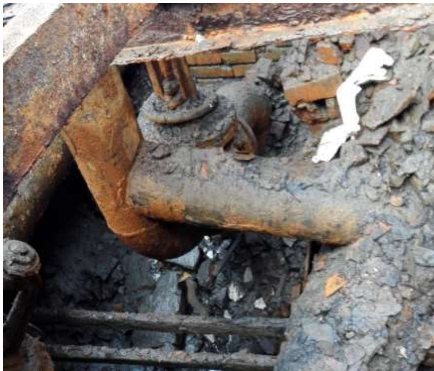
Рис. 14 – Коррозионные повреждения водопровода, постоянно находящегося в затопленном состоянии.
